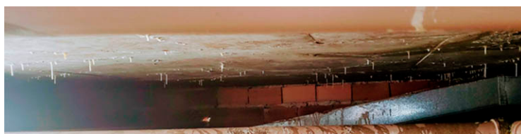
Figura 6 – Fissuras e infiltrações no fundo do reservatório
