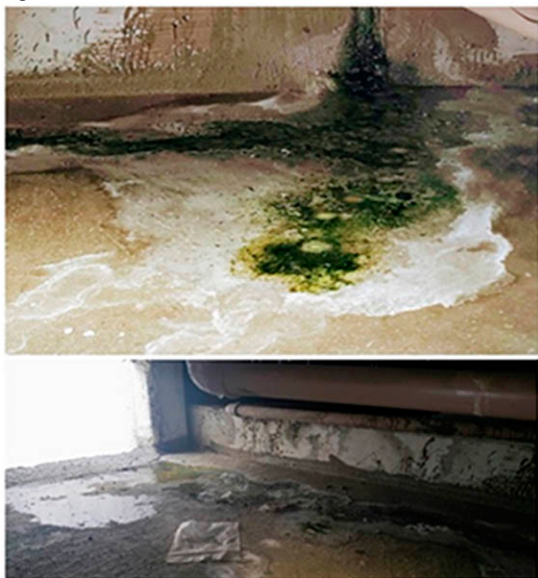
Figura 5 – Bolor e eflorescência
