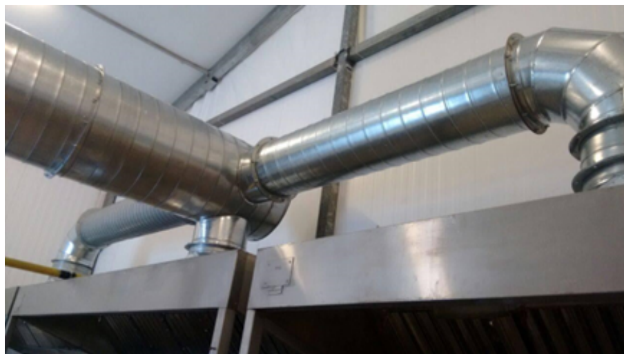
Figura 30: Figura: Dutos de chapa de aço galvanizado. Fonte: Espiro Dutos. Acesso em: 20/11/2023
